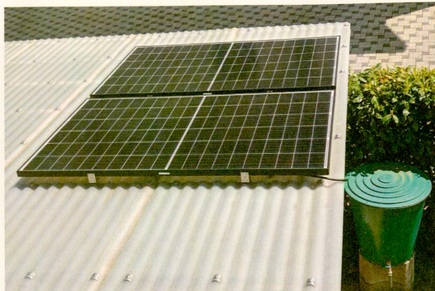
Bild 9. Die beiden 330-Wp-Panels bei der Arbeit auf dem Dach der Veranda.
